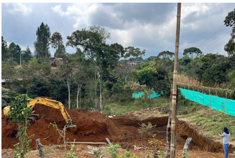
Vereda Quitapereza, Construcción Planta de tratamiento de agua potable. Inicio del proyecto.
